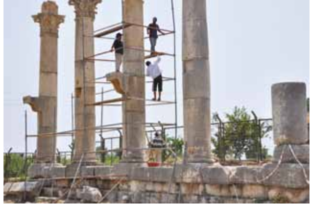
Res. 7 Sütunlu Cadde güney ucu batı portikosunda restore edilecek yedi sütundan dördü
